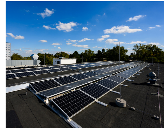
Photovoltaikanlage auf dem Dach des Demonstrationszentrum 4.0
